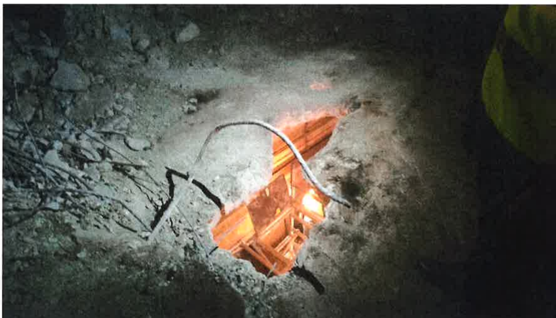
Figura 1: Rotura da abóbada do túnel do metropolitano de Lisboa
