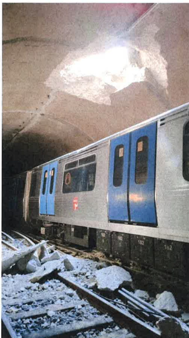
Figura 2: Danos materiais nas referidas carruagens e nas infraestruturas da linha e telecomunicações do metropolitano.
